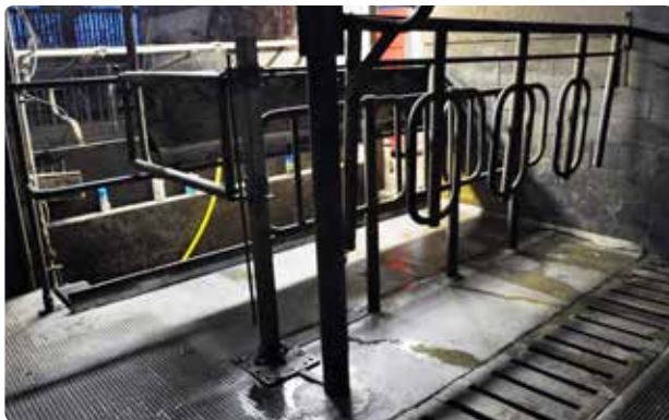
Figur 2.74. 1 x 4 parallel malkestald med fast exit som behandlingsfacilitet.
