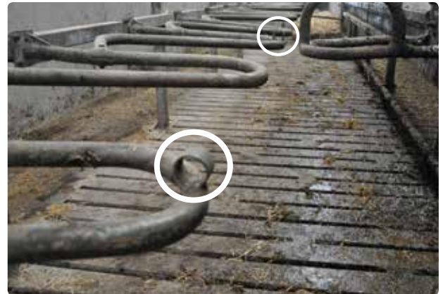
Figur 2.45. Cirklerne viser et par af de ringe, hvori et rør indsættes, så behandlingsgangen også kan benyttes som drivgang.
